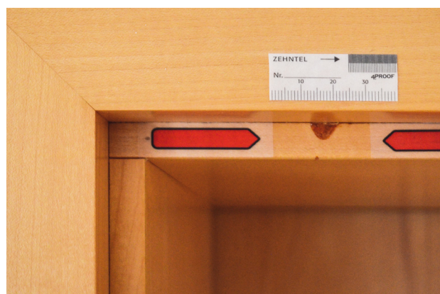
Bild 4: Heruntergelaufener Montageschaum stellt an einer Fläche im Bereich c einen Mangel dar. Foto: © Michael Bücking
